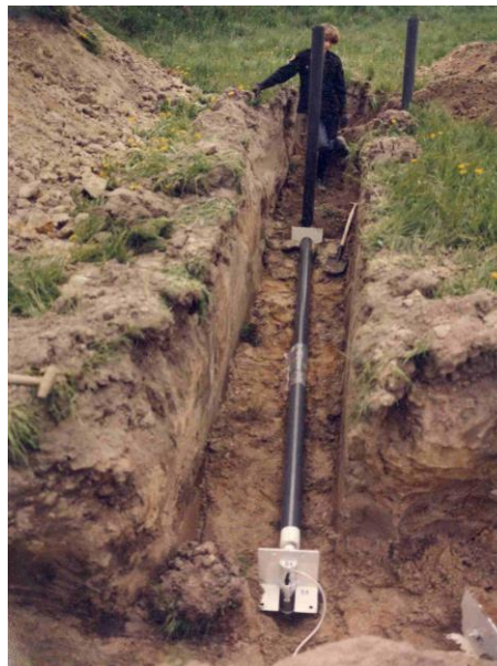
Rys. 3.1 Przetwornik deformacji gruntu w wykopie, przed zasypaniem
