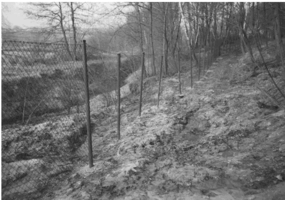
Fot. 3 Składowisko odpadów komunalnych Barycz. Osuwisko na stoku południowym (fot. K. Czajka) Fot. 3 Landfill „Barycz” in Kraków. Hill creep in of south bevel. Photographs taken by K. Czajka
