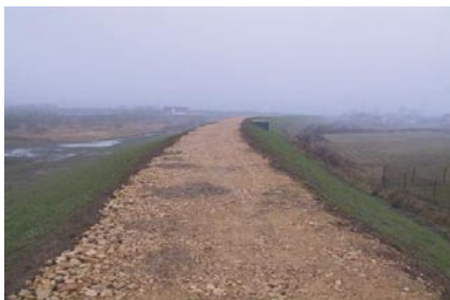
Rys. 7.3. Wybudowany wał przeciwpowodziowy w miejscowości Bobrek na rzece Wiśle wykonany ze skały pónnej pochodzącej z Zakładu Górniczego „Janina” w Libiążu
