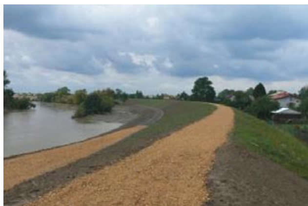
Rys. 7.4 Wybudowany wał przeciwpowodziowy w miejscowości Gromiec na rzece Wiśle wykonany ze skały pónnej pochodzącej z Zakładu Górniczego „Janina” w Libiążu
