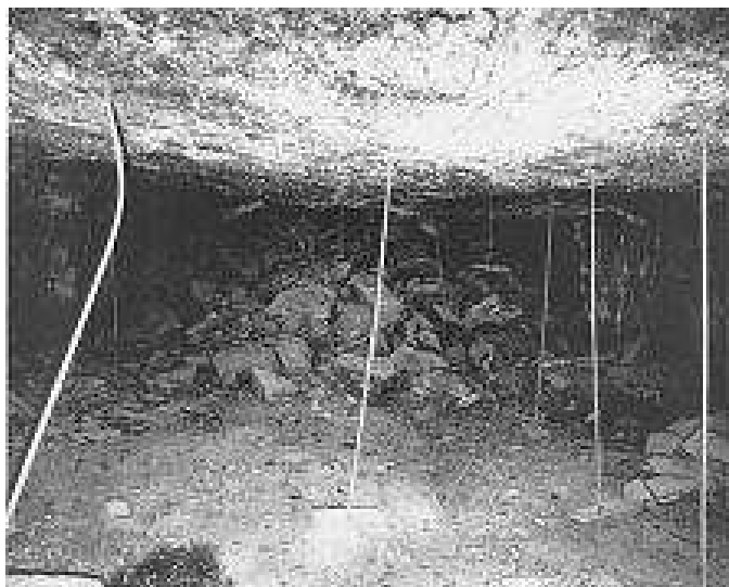
Rys. 3. Pęknięcie w stropie w podziemnym wyrobisku związane z lineamentem [24]
