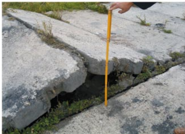
Rys. 14. Wypiętrzenia płyt betonowych drogi wokół zbiornika „Biały Brzeg”
